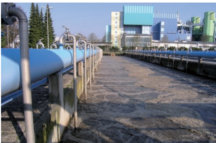
Optimierter Lufteintrag = Optimierte Betriebskosten und Umweltschonung
