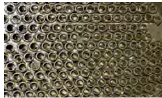
Gleicher Wärmetauscher mit 300 µm KAF-Filter. Reine Kontrollöffnung nach 9 Monaten
